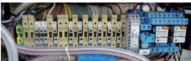
Abb. 6.10 - Sicherungen auf einer Schiene.
