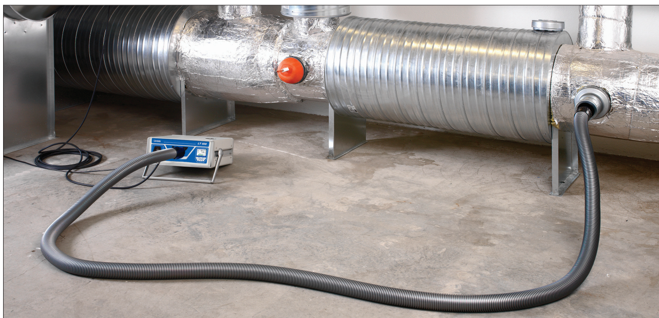
Bild 3: Anslutning till kanalsystemet
